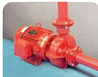
ALINHAMENTO PERFEITO ENTRE A MOTOBOMBA E TUBULAÇÃO
